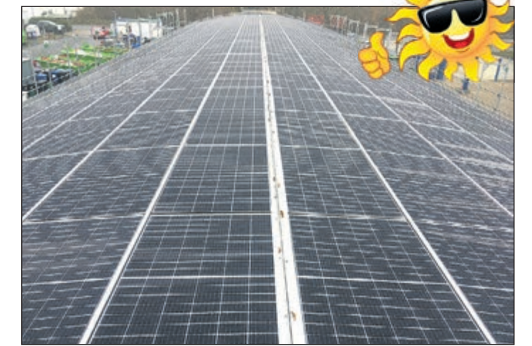
264 Module haben auf dem gewölbten Dach der Fahrzeughalle Platz gefunden. Jährlich sollen sie etwa 82.000 Kilowattstunden Strom generieren.
