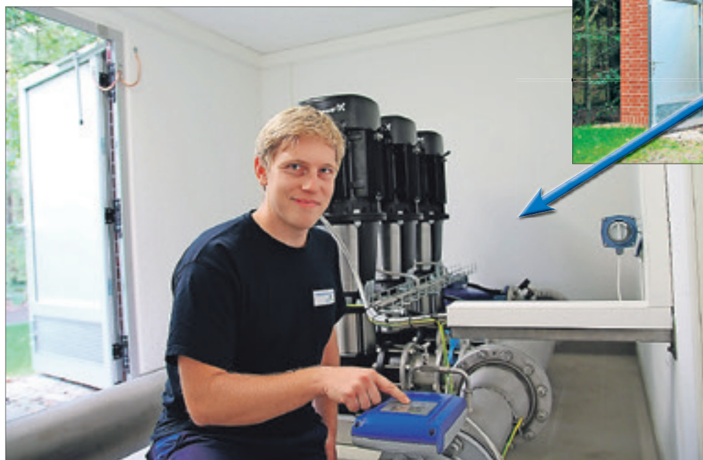
Sebastian Struß vom TV Verden überprüft im Routinecheck, ob die drei Kreiselpumpen (Leistung je 65 m³/h) in der Druckerhöhungsanlage rund laufen.
