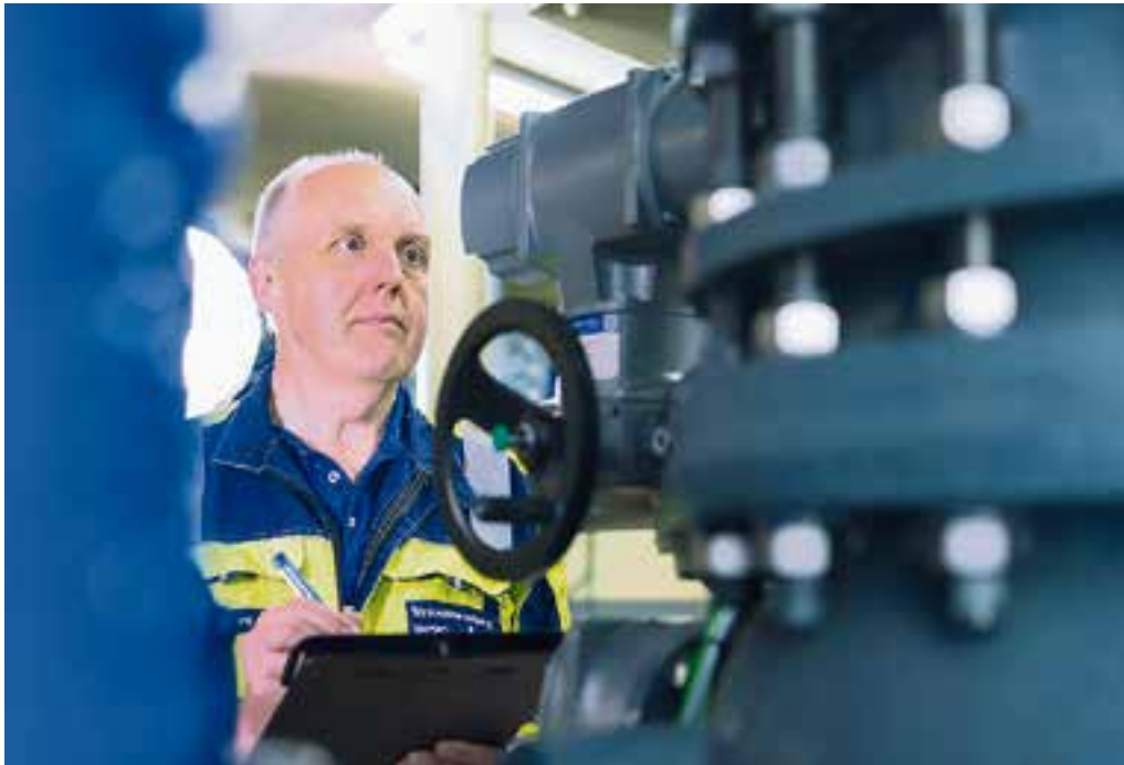
Wasserversorgung ist heute eine Mischung aus automatischen Prozessen und Überwachung durch Fachleute, wie hier im Wasserwerk Panzenberg Friedrich Ehlers.
