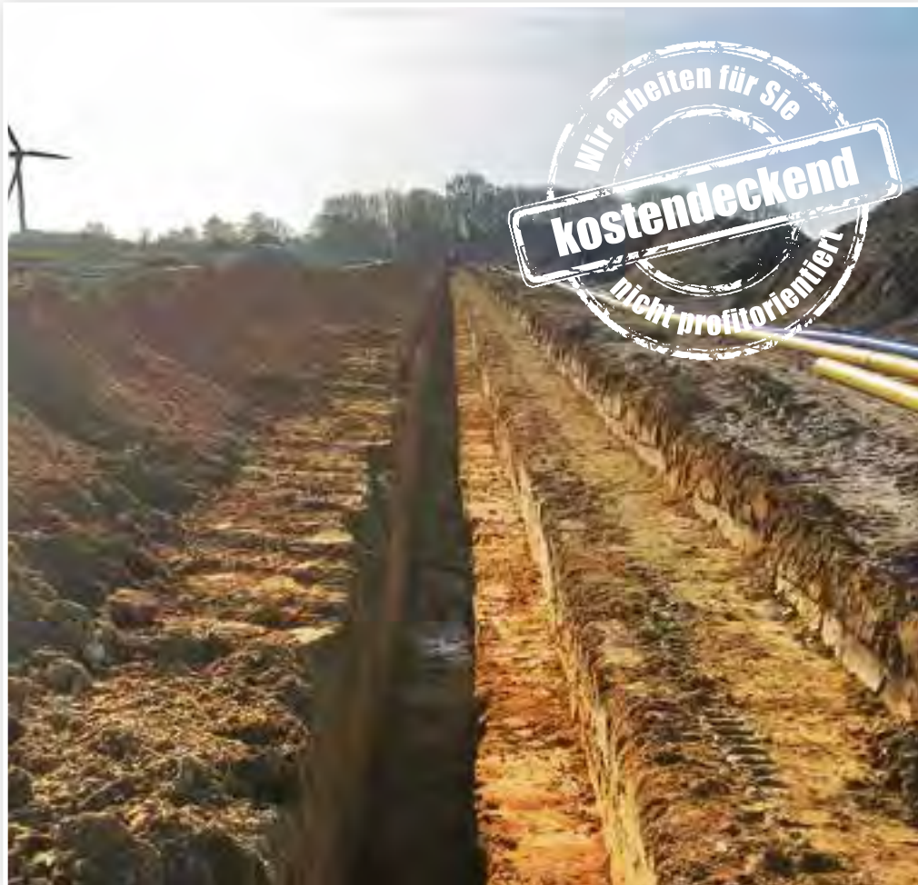
Wird Brachland erst erschlossen, spielen Leitungen unter der Erde noch keine Rolle. Bei jedem anderen Bauvorhaben ist eine Leitungsauskunft verpflichtend, um unterirdische Infrastruktur nicht zu beschädigen
