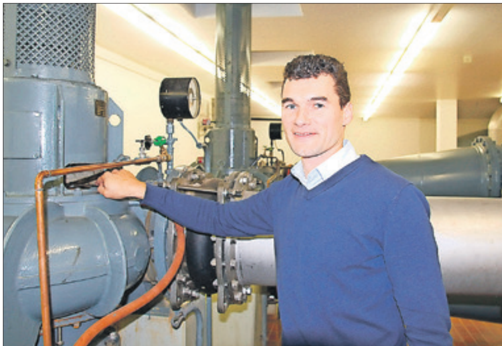
Wassermeister Sebastian Müller bei einem der regelmäßigen Kontrollgänge in der Pumpenhalle.
