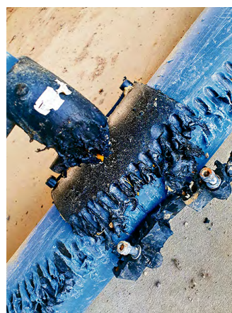
Beispiel eines Rohrschadens an einer Wasserleitung.
