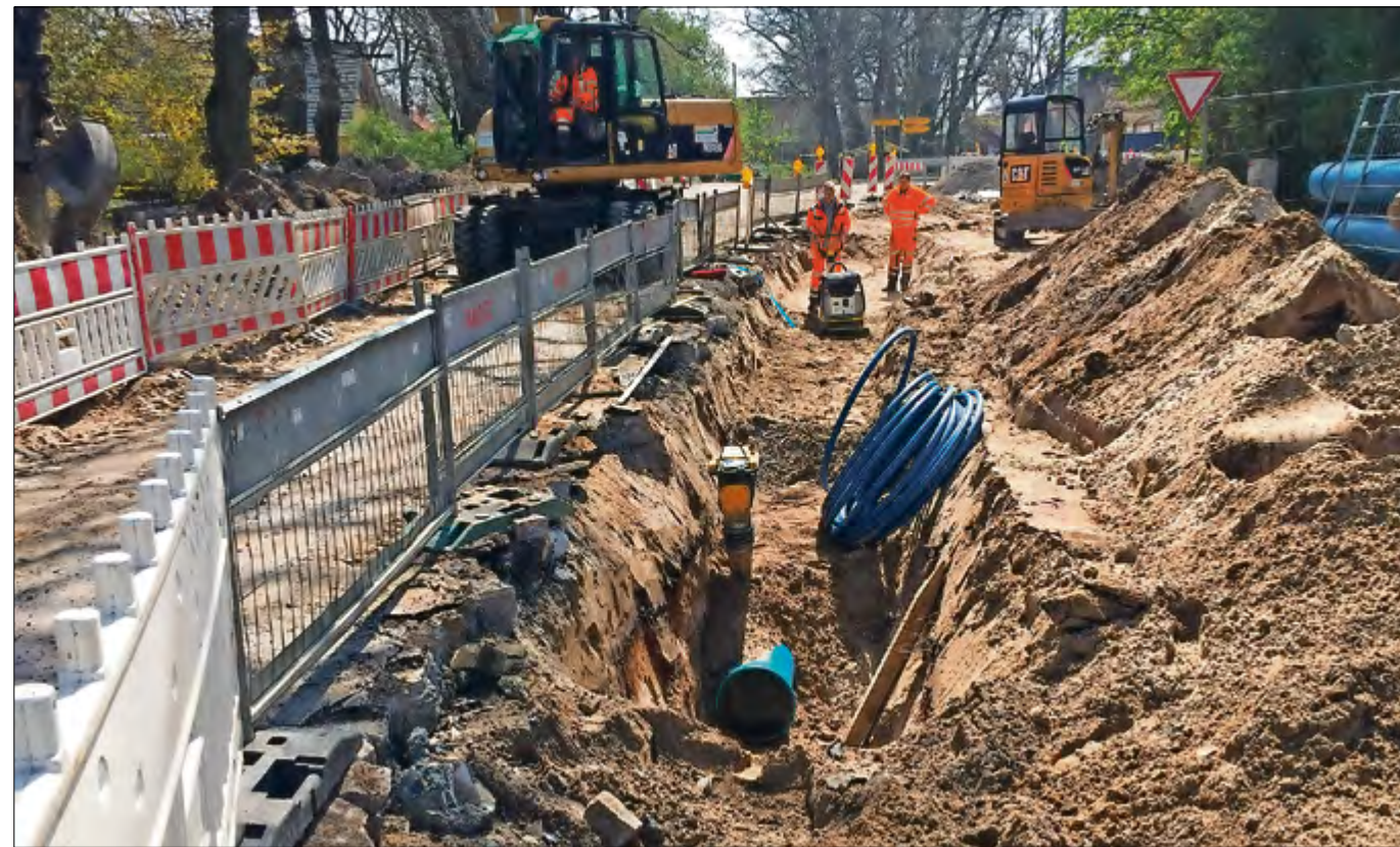
Im Zuge des Straßenbaus verlegte der TV Verden in Neddenerbergen eine neue Transportleitung.
