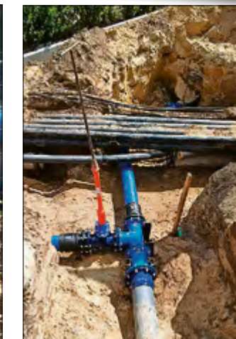
Die blaue Wasserleitung muss sich den Untergrund mit den Rohren vieler anderer Medien teilen.
