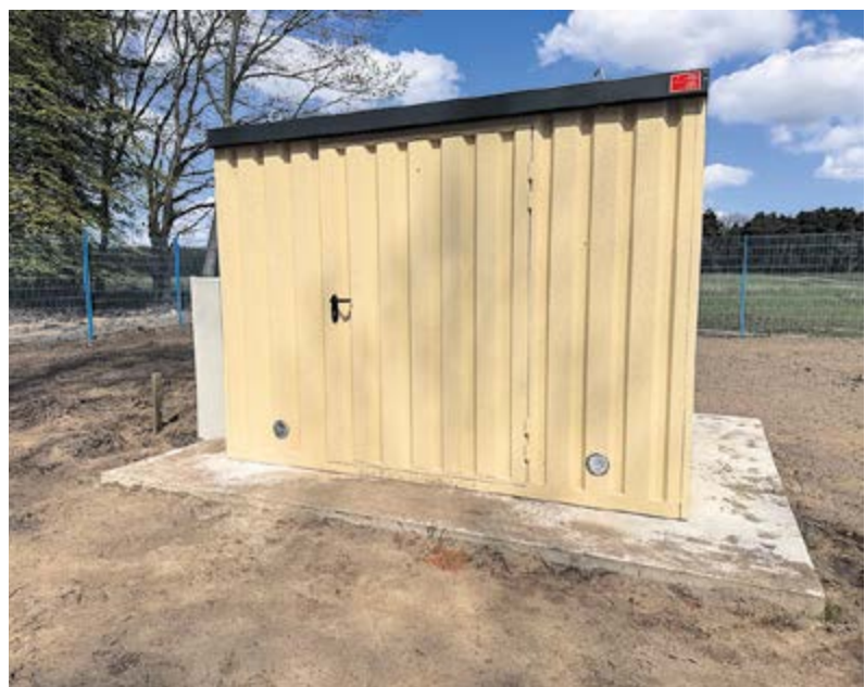
Ein gelbes Häuschen schützt die Technik des neuen Brunnens vor äußeren Einflüssen.
