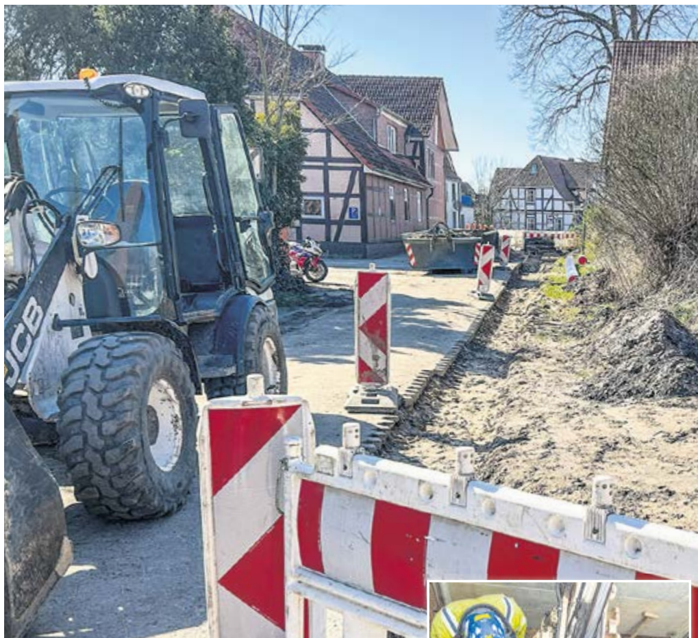
Auf etwa 130 Metern erneuerten unsere Mitarbeiter die Trinkwasserhaupttransportleitung zwischen der Fähr- und Hauptstraße.
